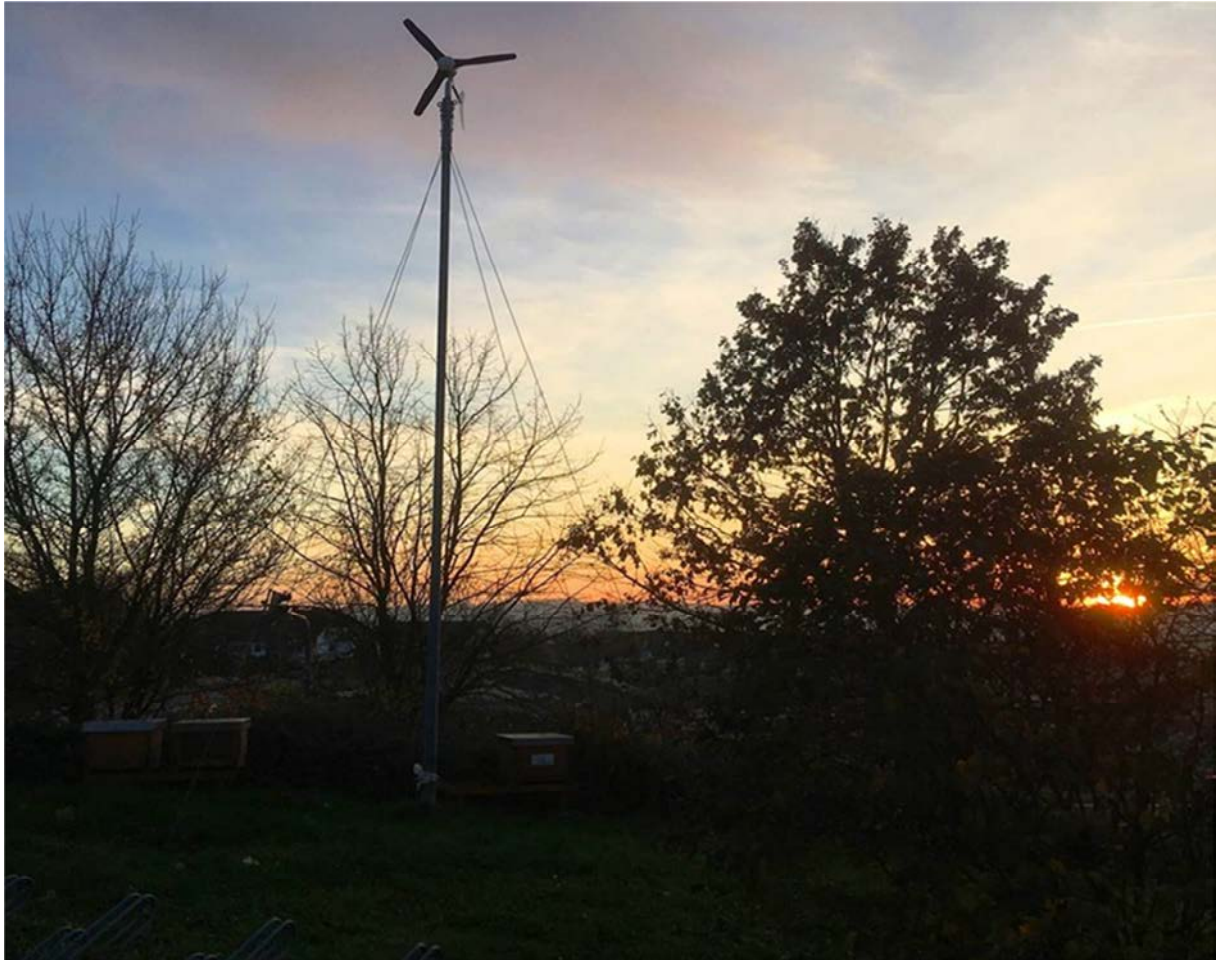
Abbildung 65: Bestehende Klein-Windrad-Anlage am Schulstandort Michelbach an der Bilz, Hagenhofweg
